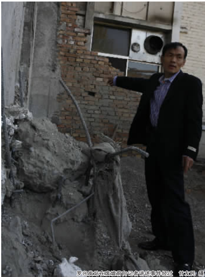
罗兴发站在废墟前向记者讲述事件经过 甘友民 摄
