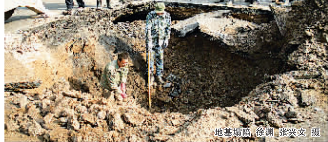
地基塌陷,徐渊、张兴文 摄
